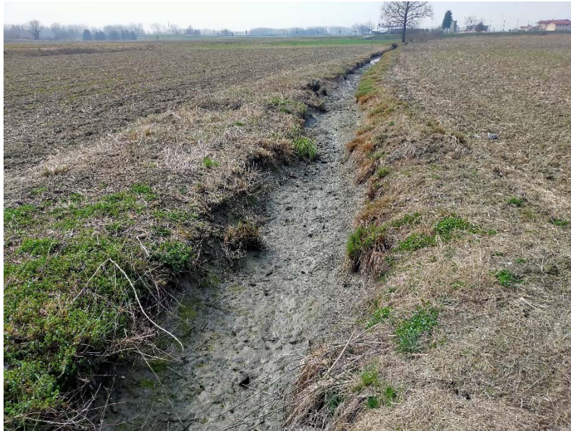
Foto 2: settore centrale del tracciato, con in primo piano il fosso proveniente dal settore dal C.na Mariale
