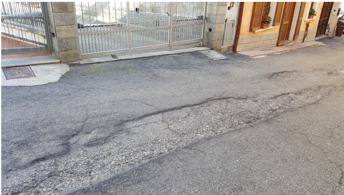
Via Cavour, dissesto, chiusini fuori quota, marciapiede a quota strada
