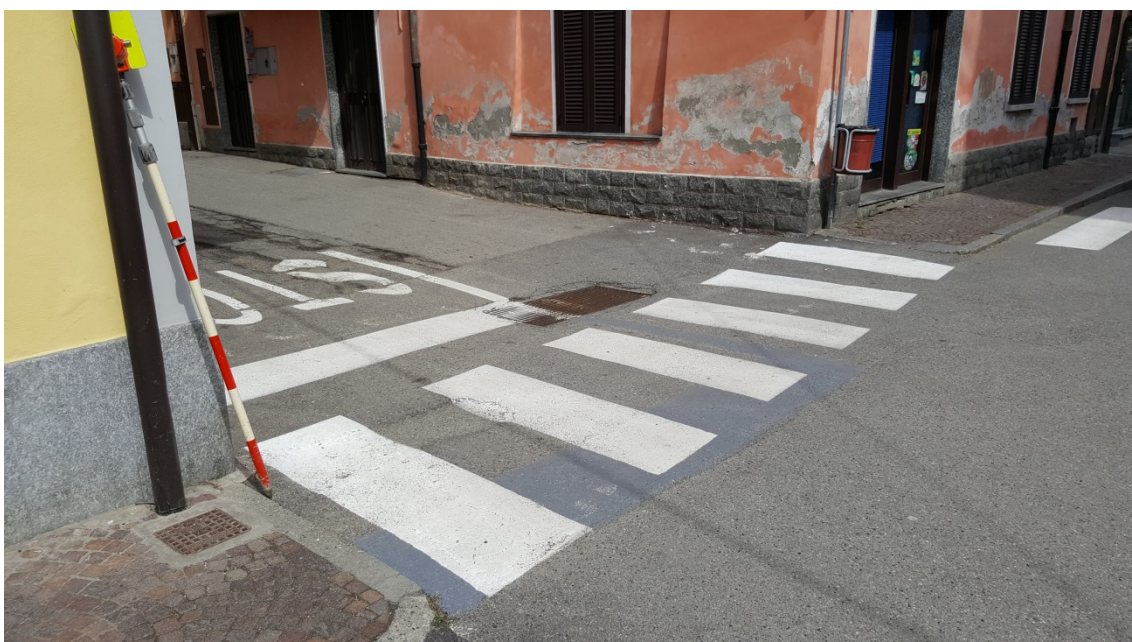
Inizio Via Roma, griglia da sostituire, zoccolature in pietra
