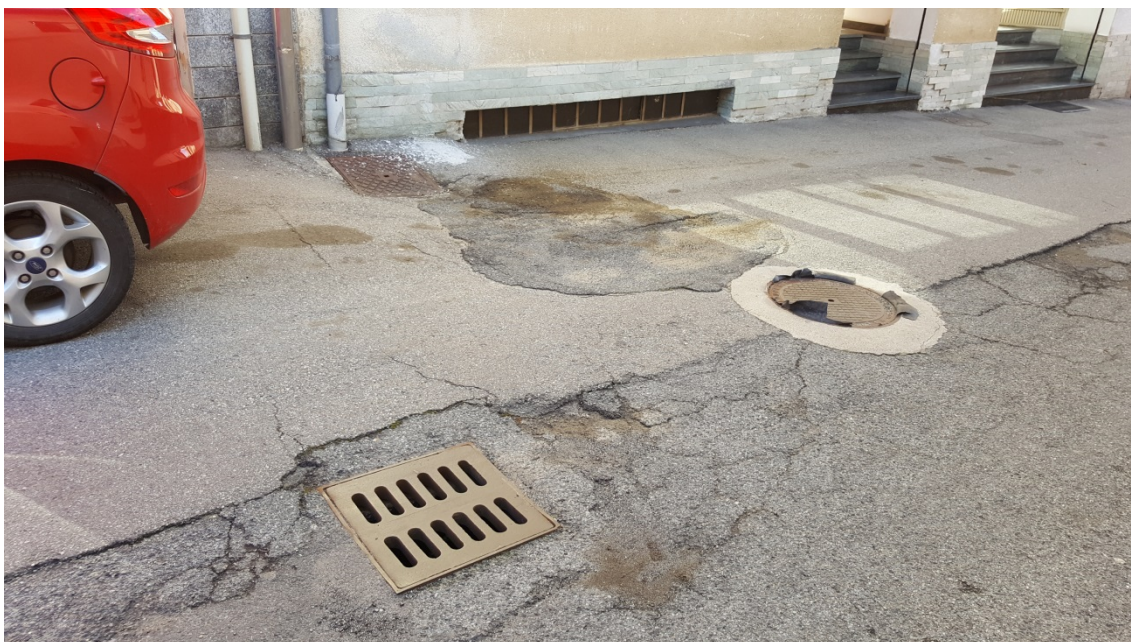
Via Cavour, griglia e chiusini fuori quota, cedimento sottosuolo, scale in pietra e aperture da proteggere, zoccolatura in pietra
