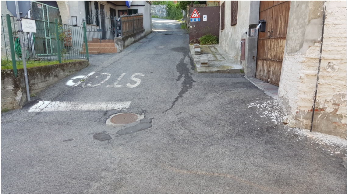
Strada vic. della Conversa inizio da Via Garibaldi, dissesto
