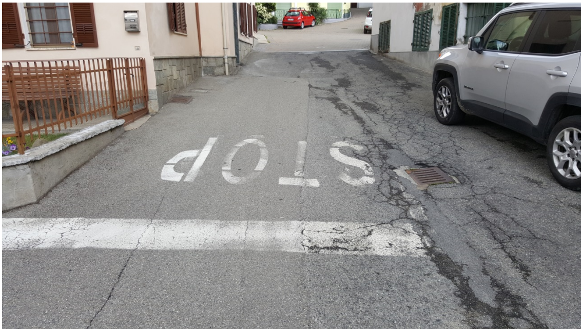
Via Roma angolo via Cavour, dissesto e griglia fuori quota
