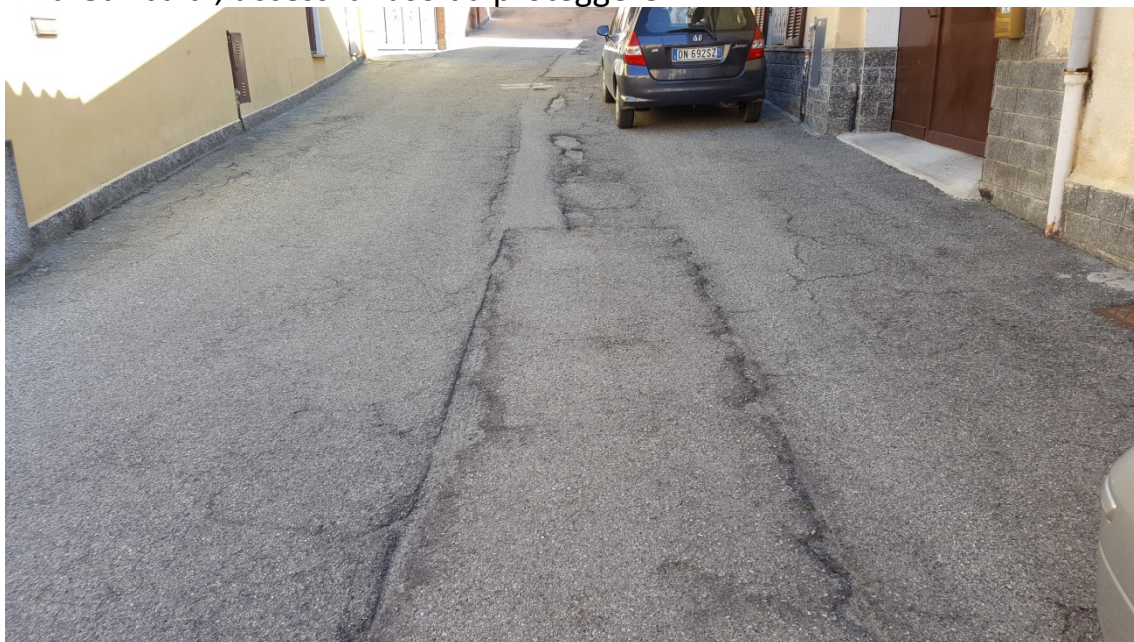
Via Garibaldi, dissesto, accessi a raso, zoccolatura in pietra
