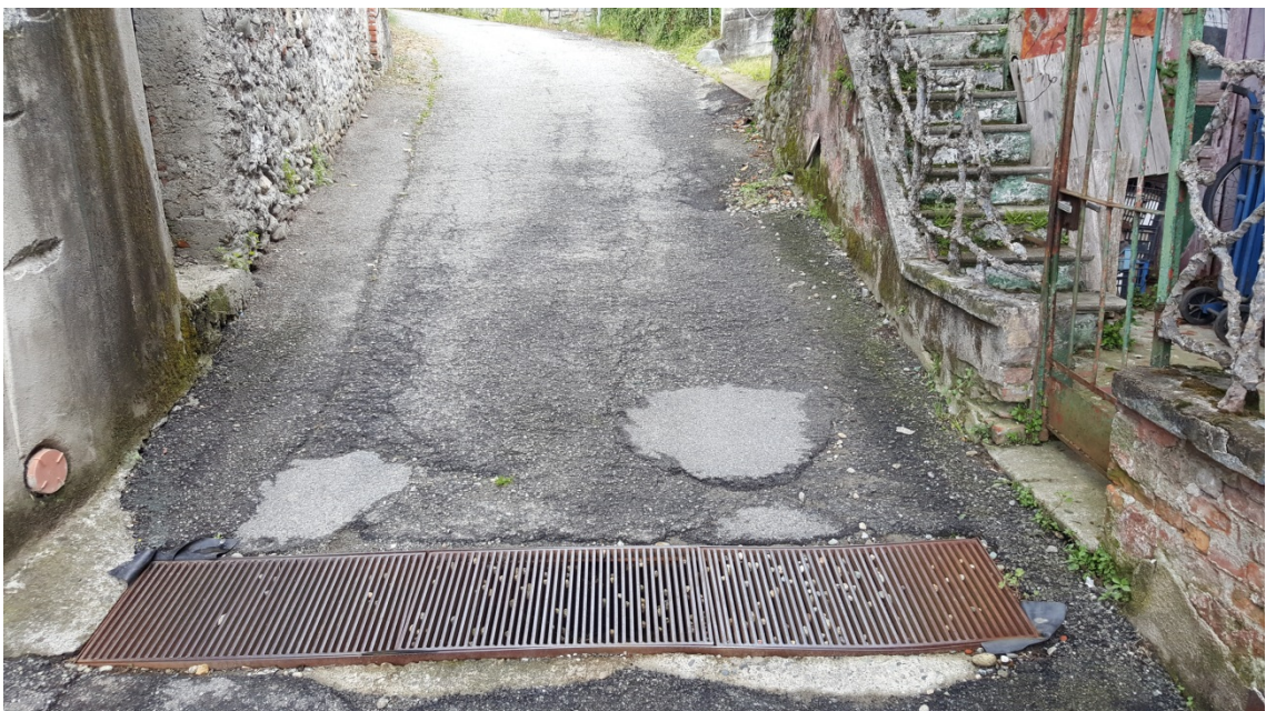
Strada vic. della Conversa, dissesto, canaletta grigliata da sostituire
