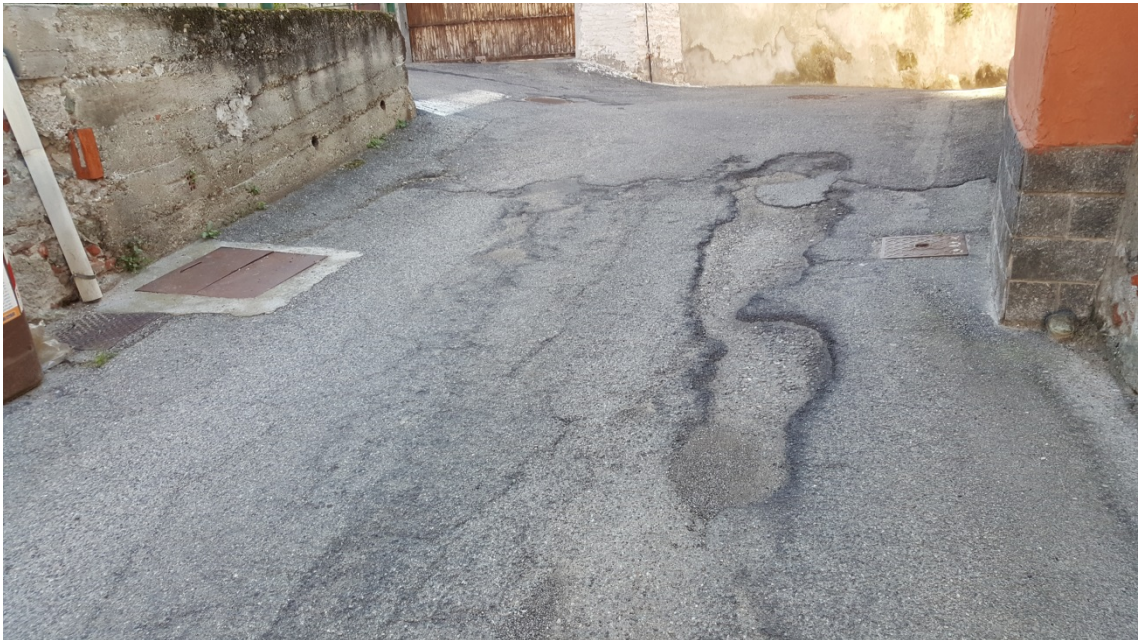
Via Garibaldi ang. Strada vic. della Conversa , dissesto
